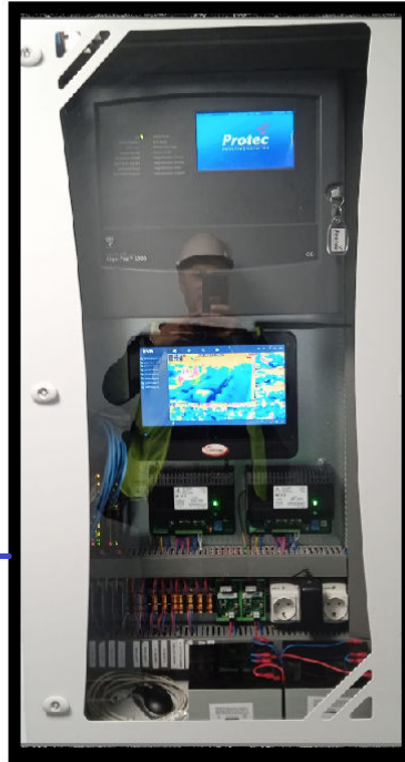
Kontrol ve Kayıt Sistemi
